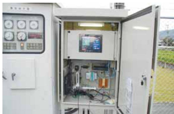
子局（柿原調整池）
