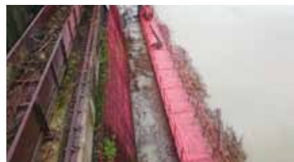
吉野川増水時に池田取水工の除塵施設前に漂着した流木などの塵芥
