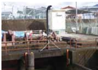
子局（更新後：ALC組立局舎）
