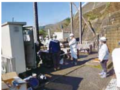
今後実施する機器更新工事のため、機能診断調査が行われました。(池田取水工)
